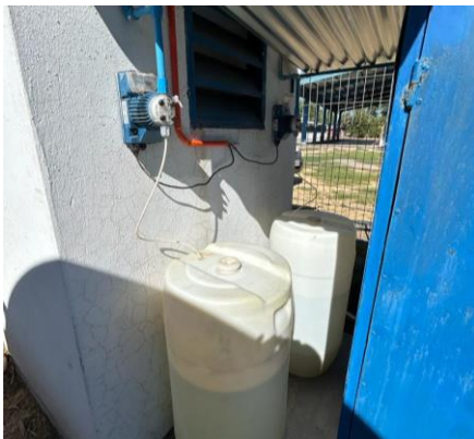
IMAGEN 52 MANTENCIÓN Y PUESTA EN MARCHA DE PLANTA DE TRETAMIENTO, ESCUELA LAS ARBOLEDAS.
