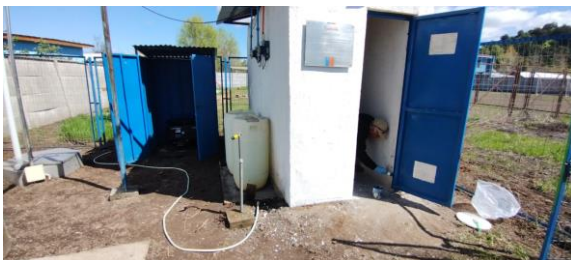
IMAGEN 39 MANTENCIÓN, LIMPIEZA Y PUESTA EN MARCHA P.T.A.S, ESC. COMALLE.
