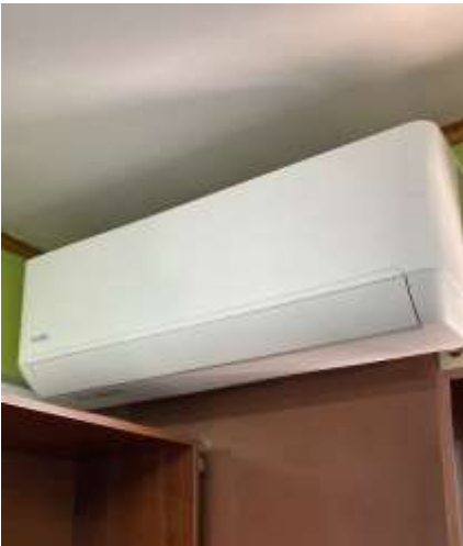
IMAGEN 29 AIRE ACONDICIONADO EN POSTA
