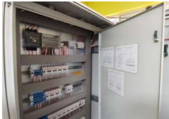
IMAGEN 15 TABLERO GENERAL DEL CESFAM DE COMALLE .
