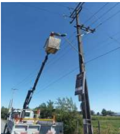
IMAGEN 89 SERVICIO DE MANTENCIÓN DE ALUMBRADO PÚBLICO.
