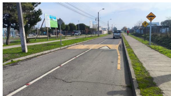
IMAGEN 16 RESALTO EN AVENIDA EL PLANCHÓN.
