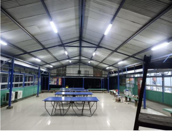
IMAGEN 33 LUMINARIAS ZONA DE PATIO.
